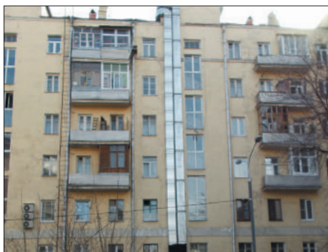
Устройство на фасаде многоквартирного дома вентиляционных коробов.
